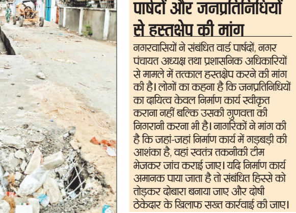
गुणवताहीन नाली निर्माण। क्षतिग्रस्त नाली का स्लेब।
